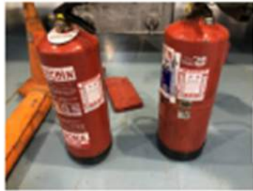
Dos extintores, próxima revisión en diciembre de 2018
